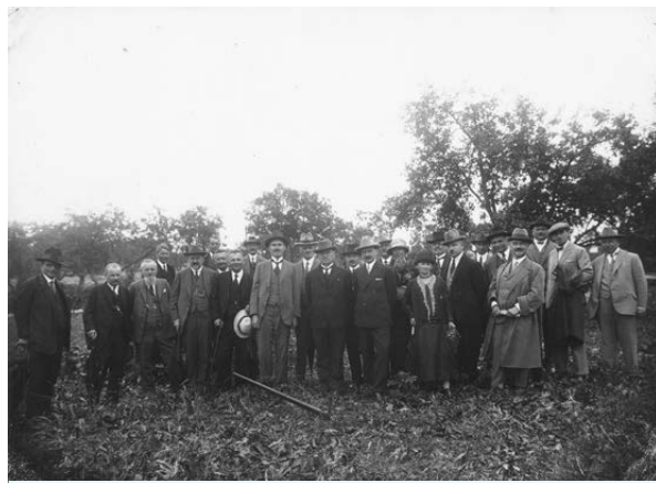
Obr. 1 Slavnostní výkop základů budoucích Sociálních ústavů hlavního města Prahy. V první řadě uprostřed v tmavých oblecích JUDr. Karel Baxa a PhDr. Petr Zenkl. (Krumpáč v popředí je dosud pietně uchován na ředitelství Thomayerovy nemocnice.)
